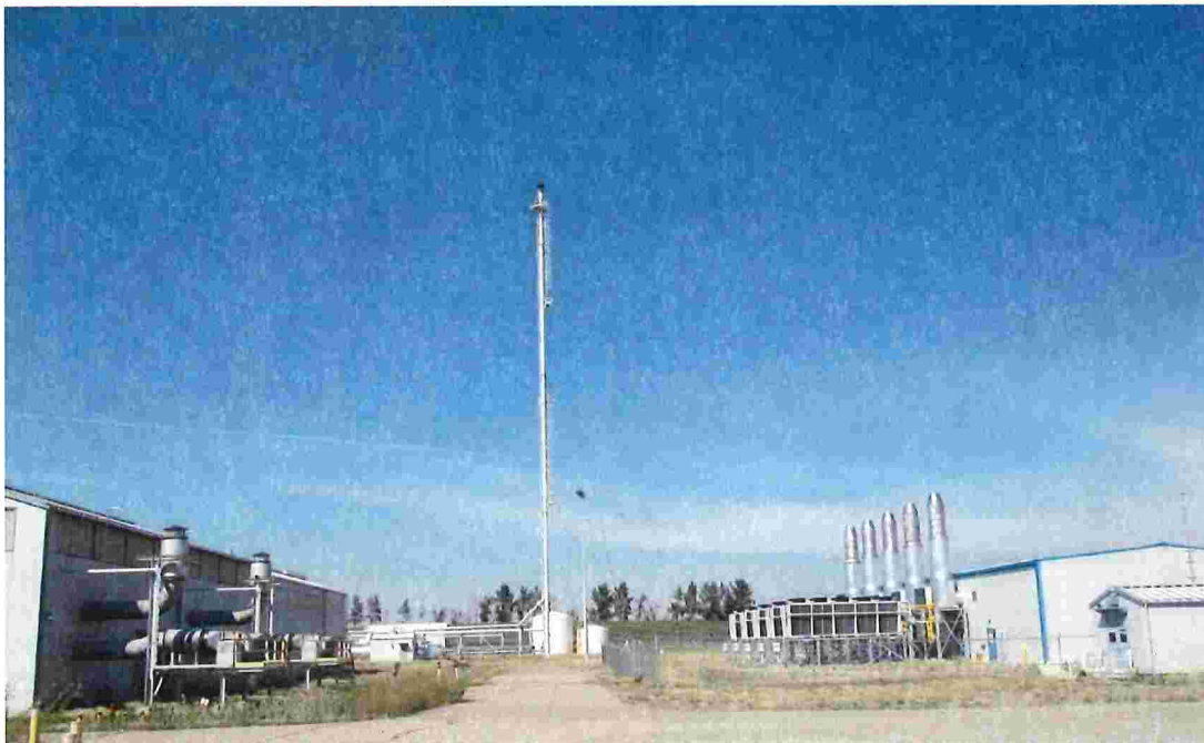
Flare Stack FL -5601
